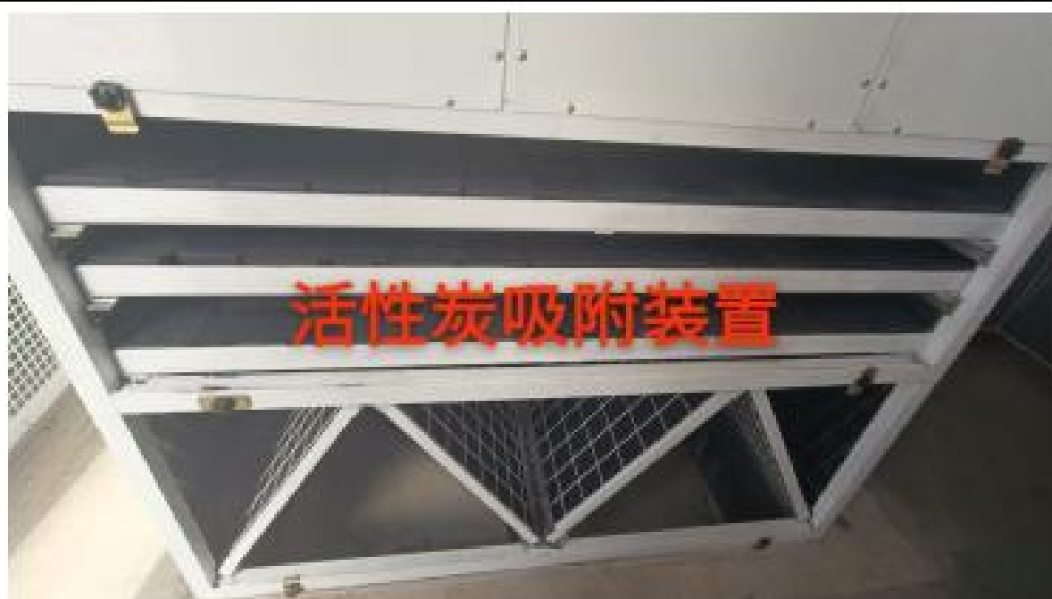
图 3-4 汽修喷漆工序活性炭吸附装置
