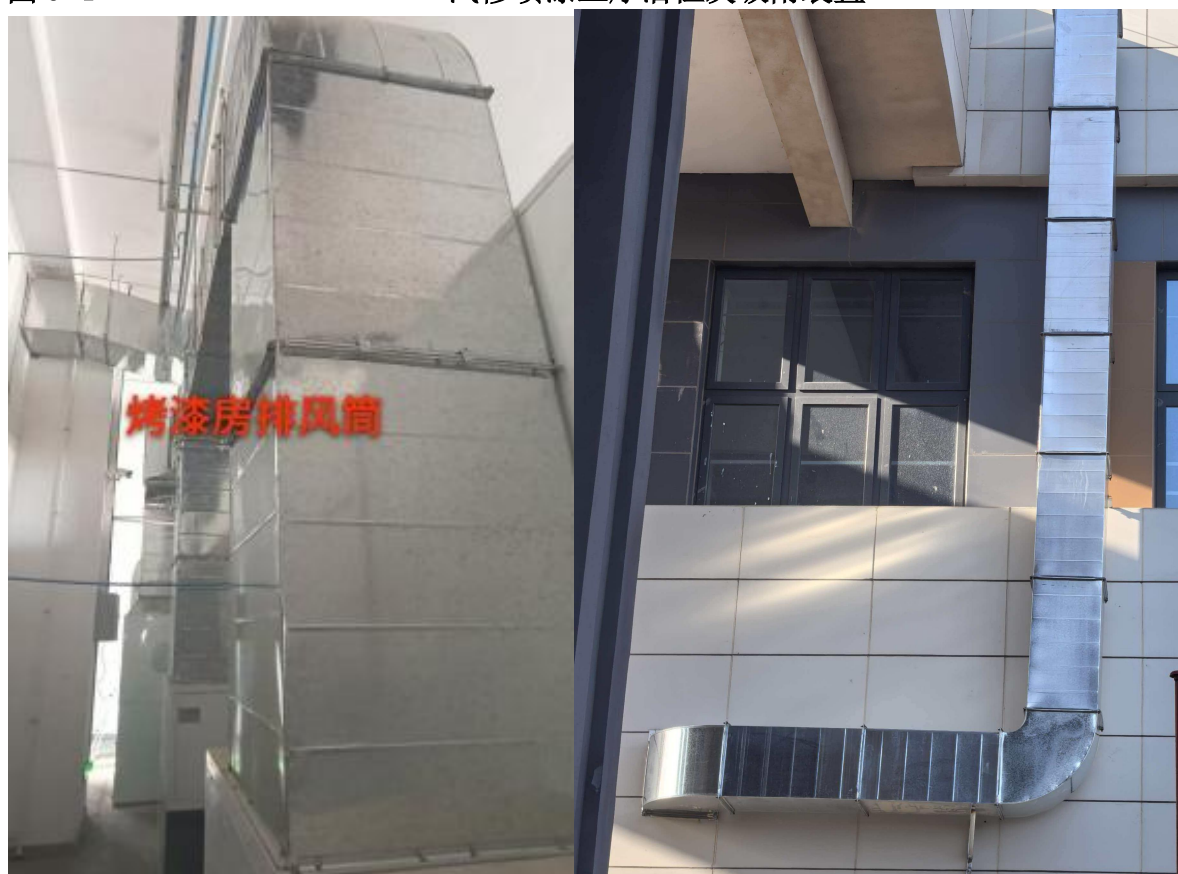
图 3-5 汽修喷漆工序排风管及 15m 排气筒
