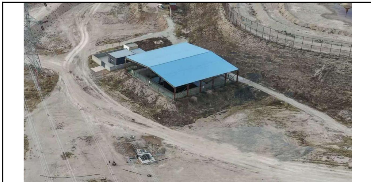
图 3-2 渗滤液收集池
