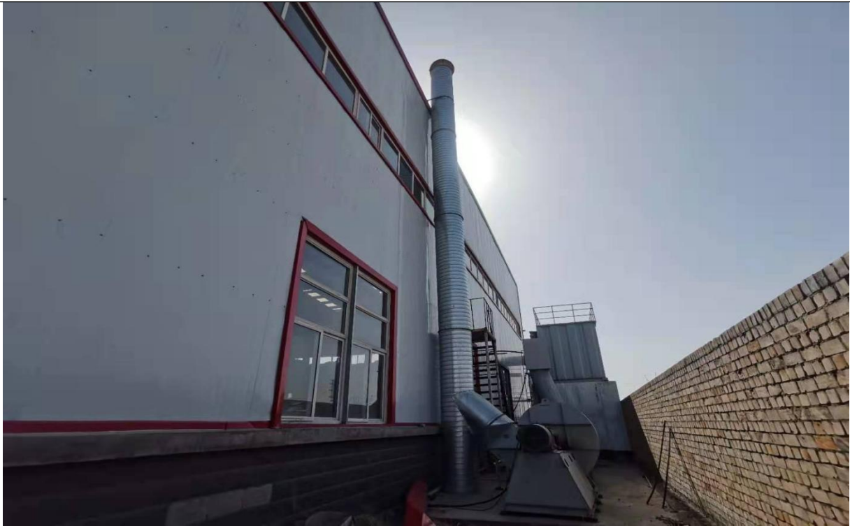
图 3-5 袋式除尘器及 15m 高排气筒
