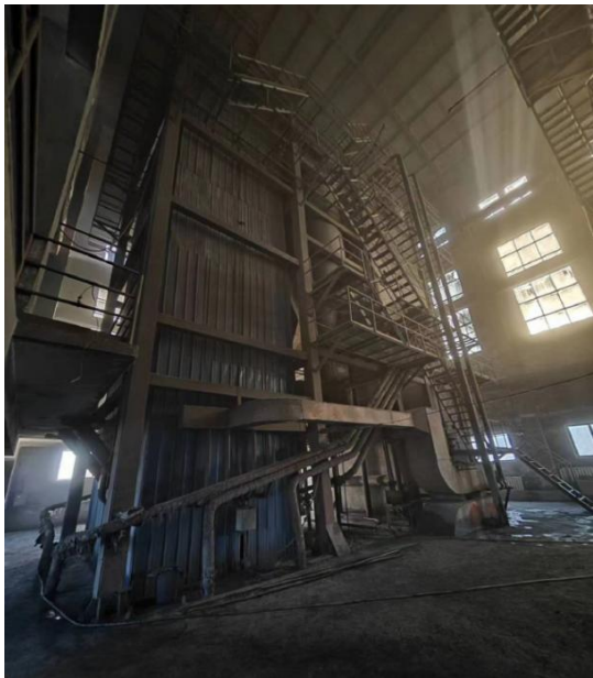
1#循环流化床锅炉（装于 2011 年，已停机）
