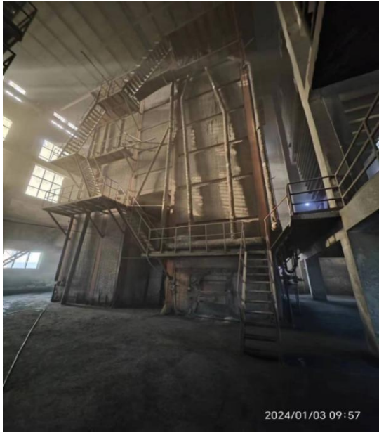
2#循环流化床锅炉（装于 2011 年，备用）
