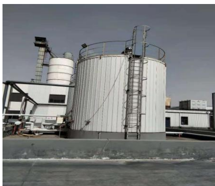
图3-15 液体沥青储罐围堰
