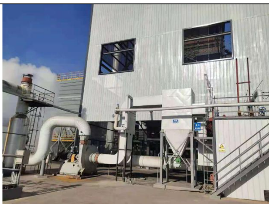
图3-9 陶瓷多管除尘器+碱液喷淋
