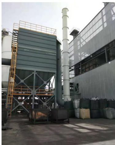
图3-5 炭化炉炉头布袋除尘器
