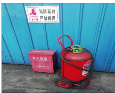
图3-18 消防设备（部分）
